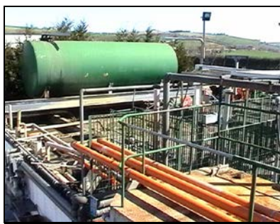
- Impianto Biologico (particolare) -
